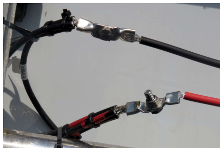
4 câbles sertis sur deux cosses. Cosses assemblées par des boulons en INOX 316.
